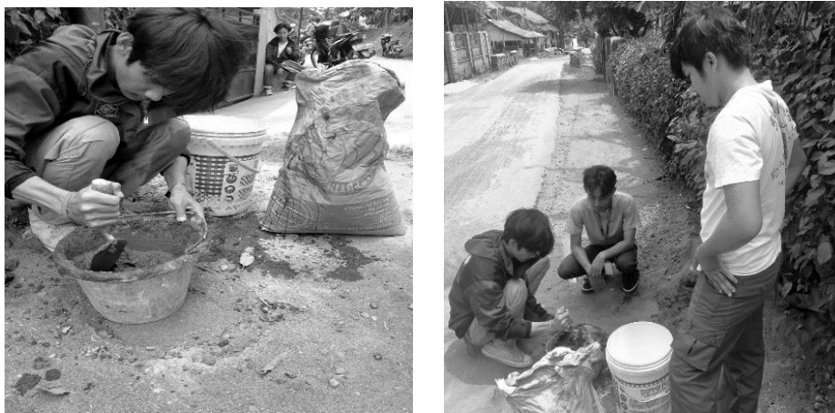
Gambar 3. Pembuatan adukan Semen untuk Pemasangan pelang dan Pembuatan adukan Semen untuk Pemasangan pelang
